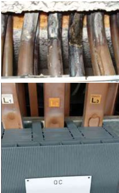
תמונה 2: נזקים שונים שנגרמים עקב הרמוניות: חימום יתר של כבילה והדקים היכולים להוביל לשריפה של ממש ולנזק תפעולי למפעל מייצר.
